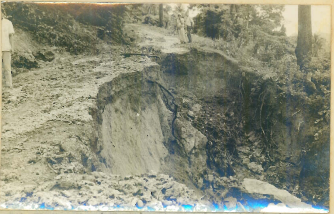
Djl. Tindjau Alam ( Tk.II ) tebing sebelah dari arah atas Lapangan Terbang ke Anak Laut longsor sepanjang \pm 15 M dan dalam \pm 10 M.
