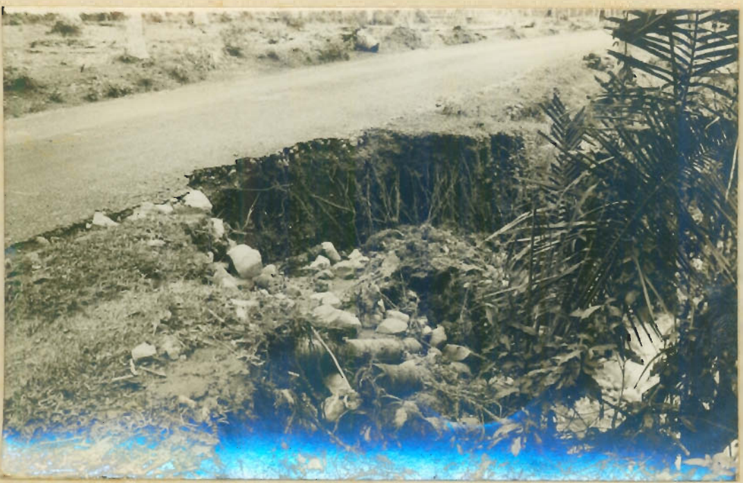
Djl. serupa diatas berm longsor sampai aspalan sepanjang \pm 15 M, dalam 3 M dan lebar 2 M. Lari longsor, paku kawat dan sebagainya telah dijalan, sumber kesesakan sudah dibersihkan sehingga perantara jalan serupa aspal dan alijiang. (Dj. Propinsi).
