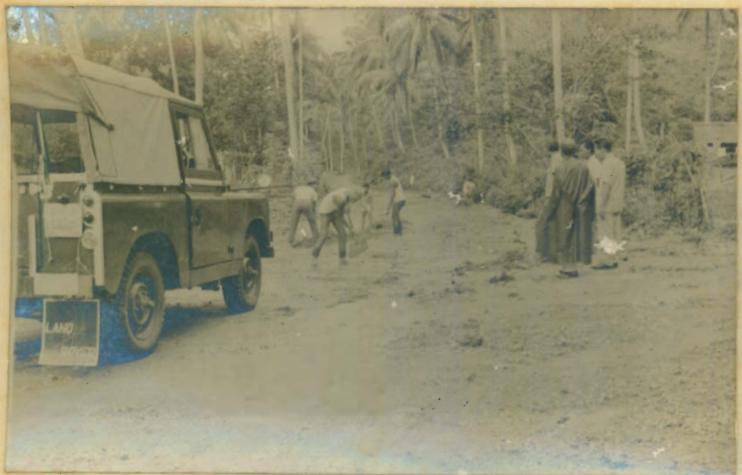
Djl. Djurusan Balohan ( Km. 9 + 500 M ) muka djalan tertimbun batu2 / pasir longsor dari bukit sebelah kiri djalan ke Balohan.
